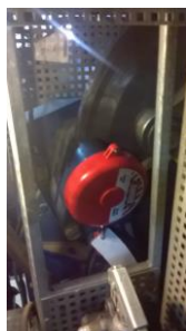
Instalación definitiva del sistema de consignación. Final installation of the LOTO system.
