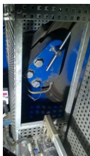
T instalada en el disco de freno completamente roscada, bloqueando el tren de potencia del aerogenerador. T installed on the brake disc completely threaded, blocking the powertrain of the wind turbine.
