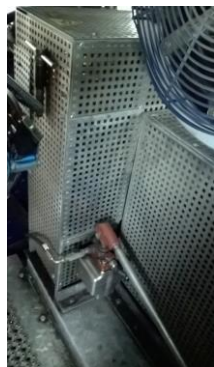
Tren de potencia, en eje rápido. Drive shaft, in speed shaft
